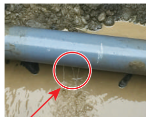
▲実際に発見した漏水箇所 (VP管φ100mm)
