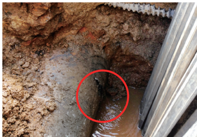
実際に発見した漏水箇所(口径1000mm)
